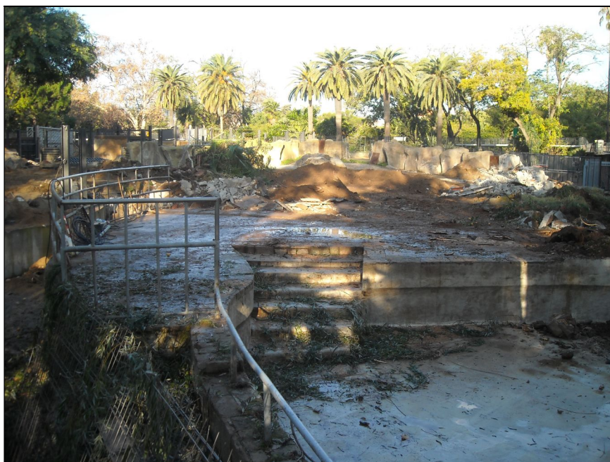
Vista general de les instal·lacions dels des de la piscina dels hipopòtams
